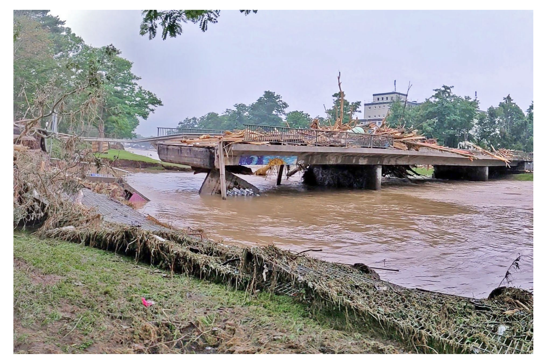
Schaden nach Überschwemmung Verklauster Durchflussquerschnitt der zur Umspülung des südlichen Widerlagers geführt hat (Foto: Becker Ingenieure GmbH)
