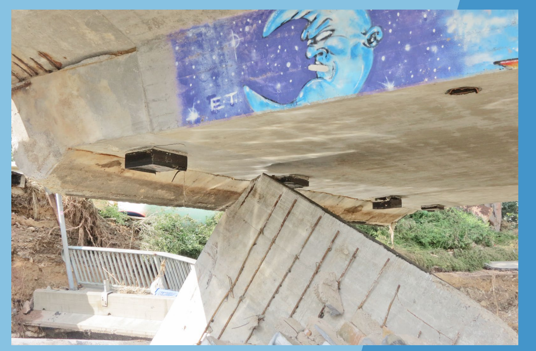
Havariert Zustand des Überbaus (Foto: Becker Ingenieure GmbH)
